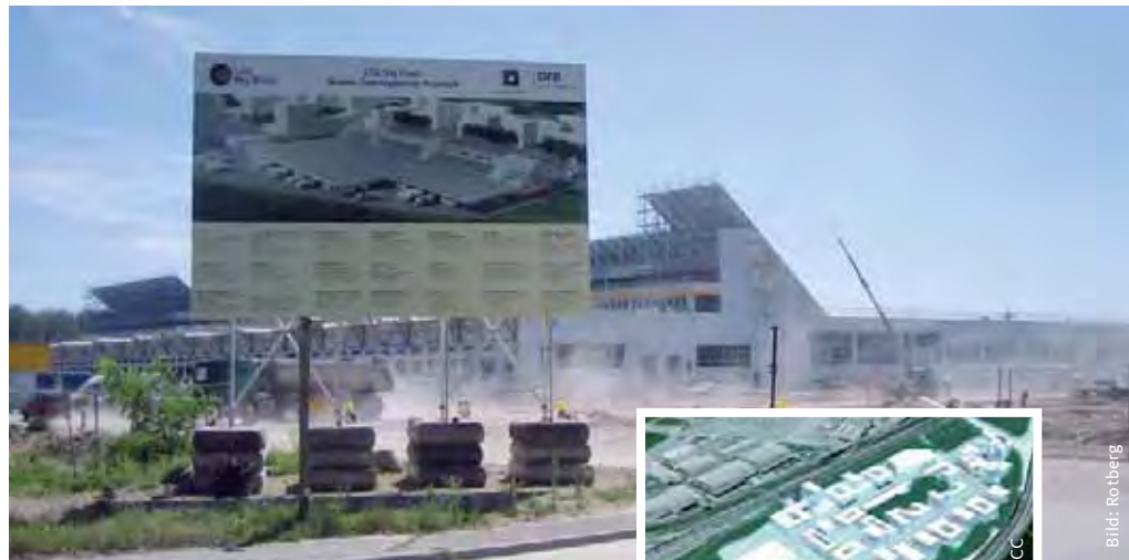
Richtfest bereits gefeiert: Auf einem 55.000 qm großen Grundstück entsteht derzeit die neue Flugküche der Lufthansa. LSG Sky Chefs ist der weltweit größte Airline-Caterer und beliefert aus nahezu 190 Betrieben rund 270 internationale Fluggesellschaften mit Borddienstleistungen.
